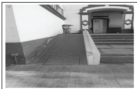
Figura N° 7: Rampa aladaña al casino conectando el Ala B al patio. Se considera como una rampa inaccesible.
